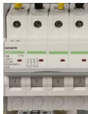
Figura 4 - Interruttore automatico magnetotermico: posizione di ON - Acceso
