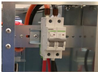
Figura 26 – Quadro elettrico RA.Store-3Bplus: interruttore di ON/OFF
